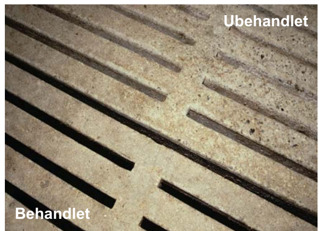
Spaltegulv efter ca. 2 års brug.
